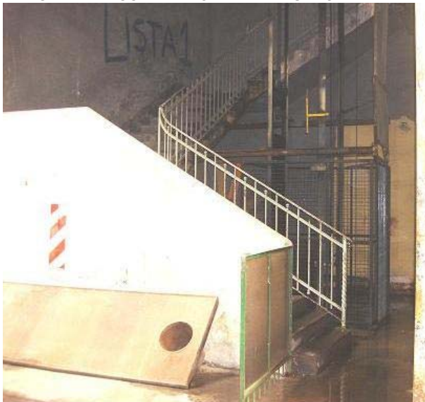
FOTO 18 / ASCENSOR EN DESUSO. ESCASA ILUMINACIÓN ARTIFICIAL EN CAJA DE ESCALERA. NO SE VIO EN TODA LA RECORRIDA LUZ DE EMERGENCIA.
