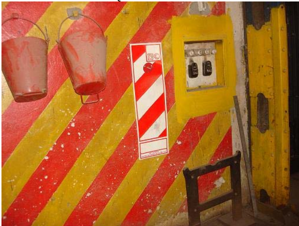
FOTO 13 / FALTA DE EQUIPOS EXTINTORES ACORDES A SU CARACTERÍSTICA DE CARGA DE FUEGO.
