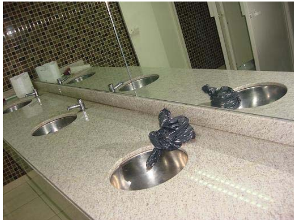
FOTO 3 / Baño Hombres del 7° piso ala Perón: Grifería anulada, envuelta en bolsa negra para su reparación.
