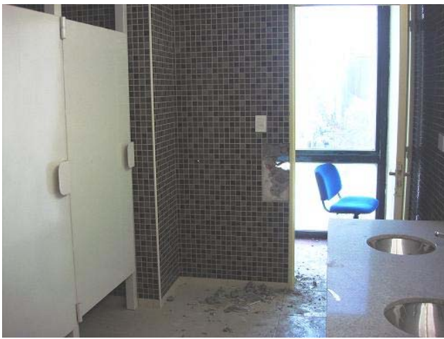
FOTO 8 / Baño Hombres 3° piso ala Sarmiento: Cerrado con llave y sin uso desde su inauguración. Falta de elementos seca manos, porta papel, jaboneras y cesto papelerero. Se debió forzar la entrada para su ingreso por falta de llaves.
