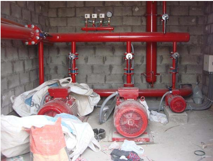
FOTO 9 / INTERIOR DE LA SALA DE BOMBAS.
