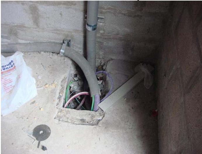
FOTO 10 / ENTRADA DEL CABLE TRIFÁSICO QUE VIENE DE LA CALLE.
