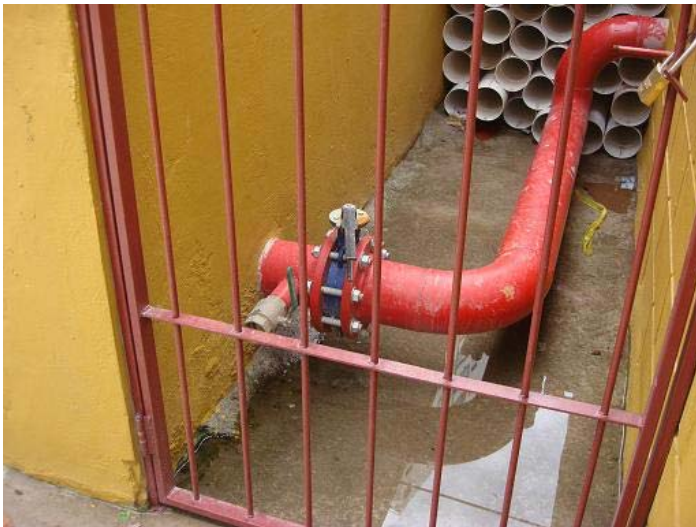
FOTO 13 / CAÑO DE AGUA QUE CONECTA TANQUE DE RESERVA CON LAS BOMBAS LLAVE DE PASO CERRADA.
