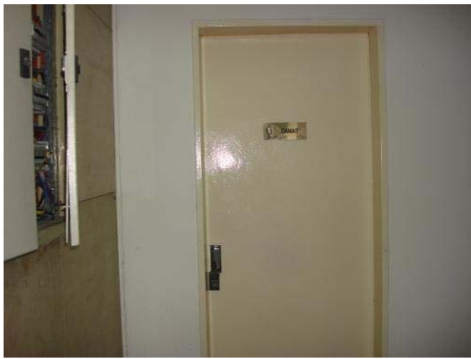
FOTO 4 / Baño Mujeres 7° piso ala Sarmiento: Caja seccional de iluminación del piso abierta. Baño cerrado con llave.
