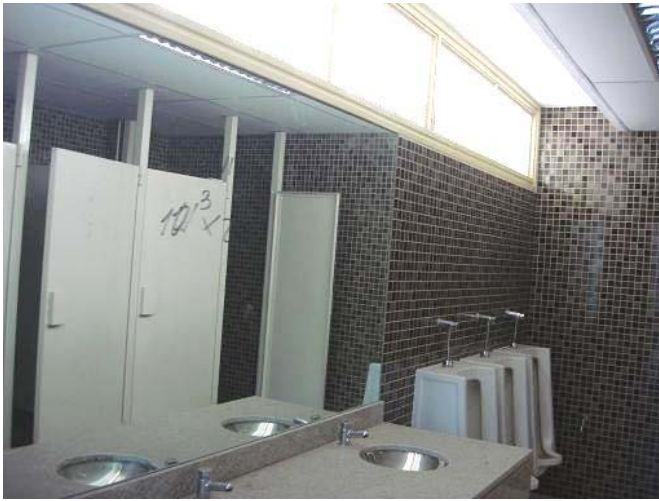
FOTO 9 / Baño Hombres 3º piso ala Sarmiento: Espejo escrito todavía con medidas de obra. Baño no utilizado desde el final de obra.
