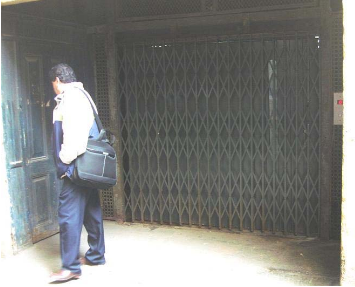
FOTO 17 / ASCENSOR CON SISTEMA TIJERA. NO CUMPLE CON LA ORDENANZA N° 49308/CJD/95.
