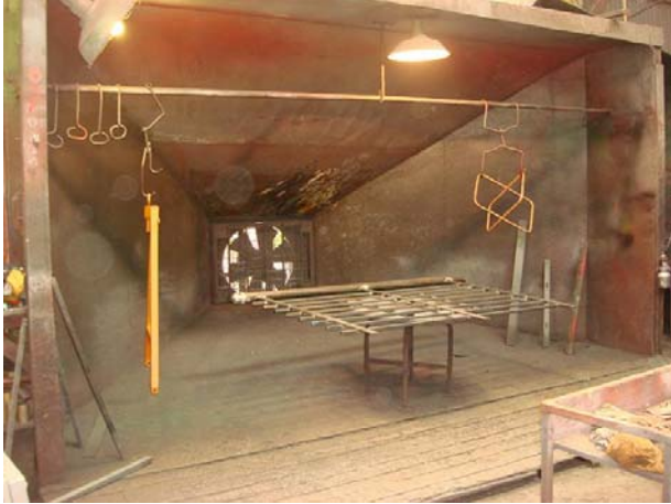
FOTO 12 / Sector Pintura: EXTRACTOR QUE TIENE SALIDA A LA CALLE, SIN FILTROS DE CONTENCIÓN DE PARTÍCULAS DE PINTURAS, HUMOS Y GASES.
