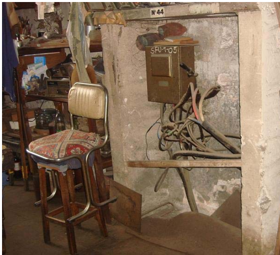
FOTO 11 / Sector Herrería: ENTRADA DE ENERGÍA ELÉCTRICA MUY PRECARIA Y DE ALTO RIESGO.
